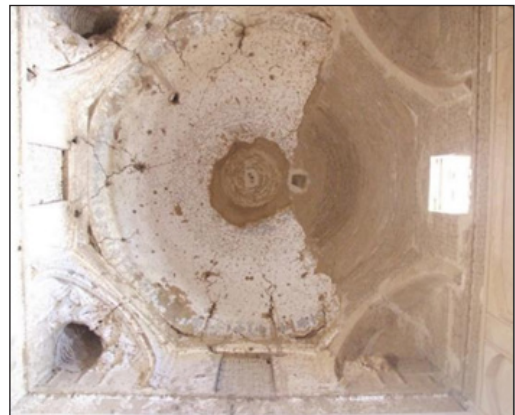
تصاویر ۵. نمای زیرگنبد بقعه که بخش بازسازی شده در سمت راست مشخص است (عکس از: نویسنده).
